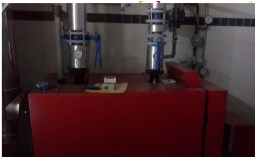
Imagen de la caldera de propano para calefacción
