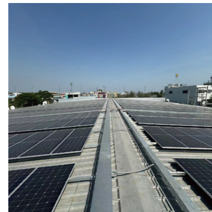
泰国超市屋顶光伏—RSD
