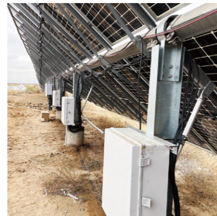
宁夏国能地面电站保护器项目
