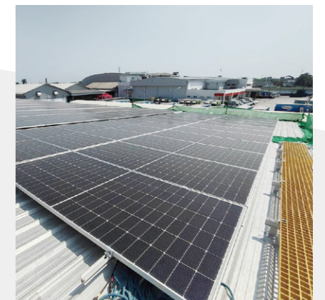
泰国比達多工厂屋顶光伏—RSD
