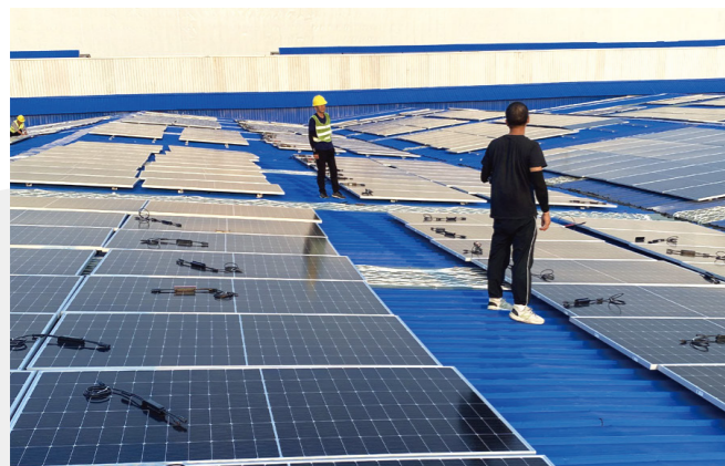
徐州华能宝元项目智能安全保护器 5.8MW 项目
