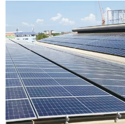
马来西亚吉隆坡智能安全优化器项目
