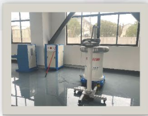
150kV工频耐压设备
