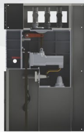
12kV-充干燥空气
